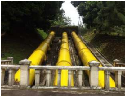
Gambar 3. 7 Penstok yang digunakan di PLTA Ubrug Sukabumi
