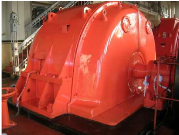
Gambar 2. 2 Generator (Hasil Survei PLTA Ubrug, Sukabumi)
