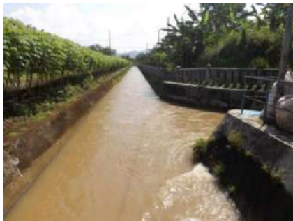
Gambar 2. 15 Saluran Pengambil Air pada PLTA Ubrug
